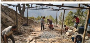
खपाङ्गी डाँडा घाटेपाटी तथा सतल निर्माणको लागि चङेरी खारी मकिए पछिको अवस्था ।
